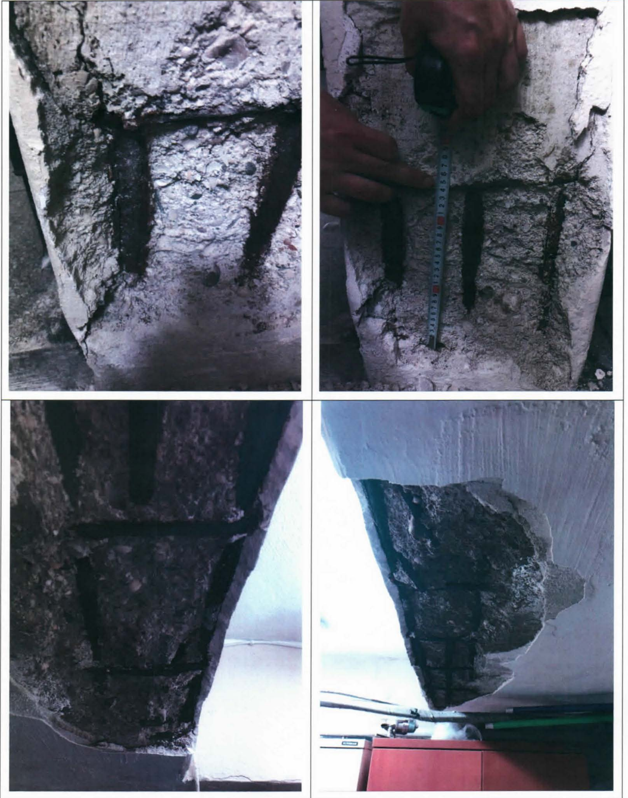
Şekil 2. Bodrum kat kolon ve kirişlerinde tespit edilen hasarlar.
