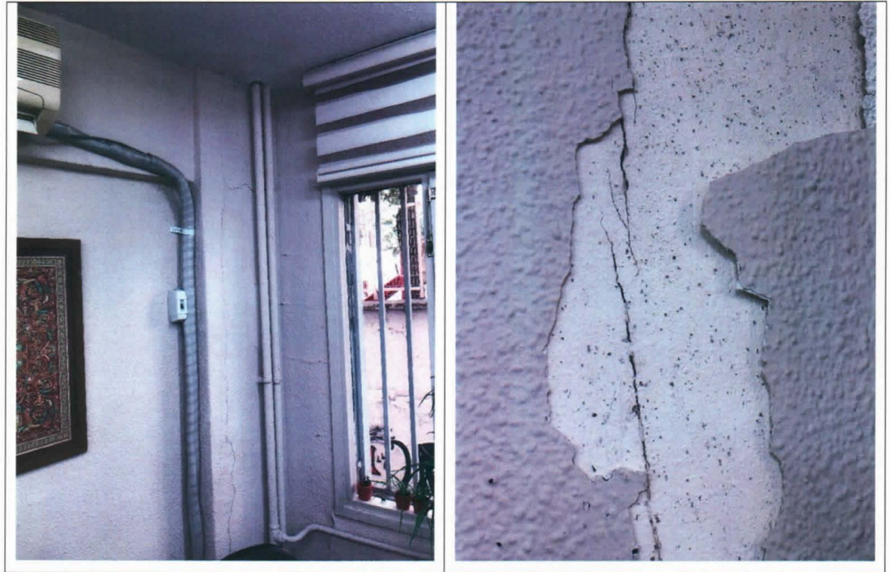
Şekil 4. 2. Kat kolonunda yer alan hasarlar.
