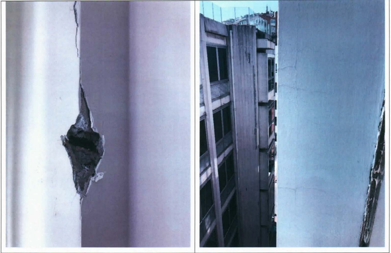
Şekil 5. 5. kat kolonlarında yer alan hasarlar.
