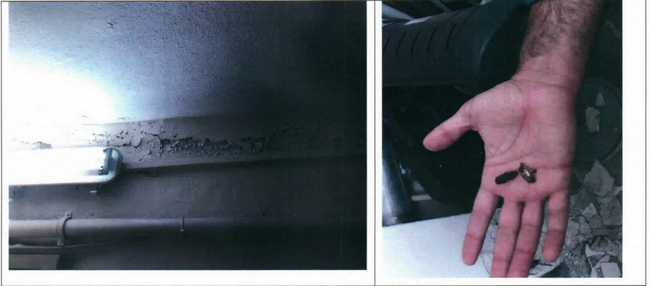
Şekil 3 Solda yapıdaki rutubet, sağda rutubetin neden olduğu korozyon sonucu donatılardaki duruma ait şekiller
